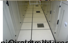
Servidor em um piso elevado monitorado 24 Horas
